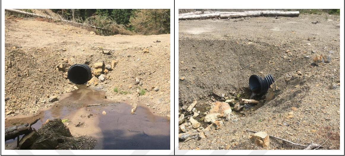
Şekil 1.6. Koruge borunun menfez olarak kullanımı. Memba yönü (solda), mansap yönü (sağda).
