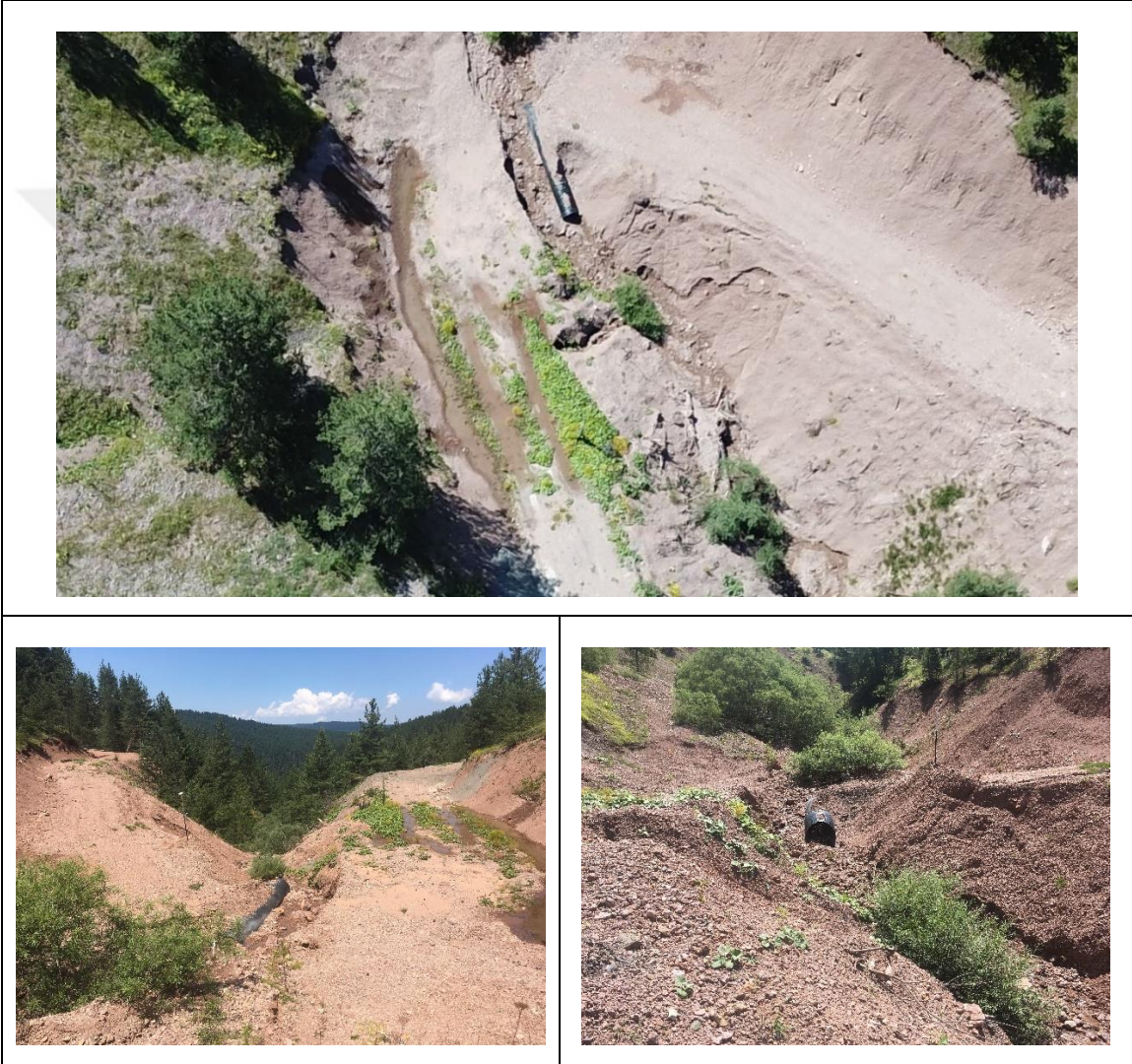
Şekil 3.7. Suyun yol dolgusunu oyması nedeniyle yer değiştirmiş yapı örneği.
