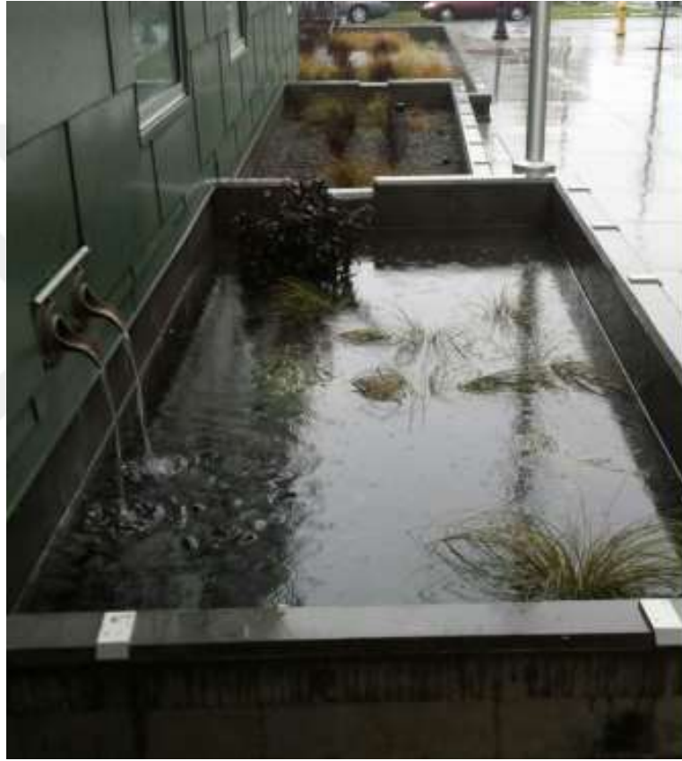
Şekil 1.78. Çatı drenajına bağlanan taş bitkilendirme kutuları, Portland, ABD (JSWDC, 2022)
