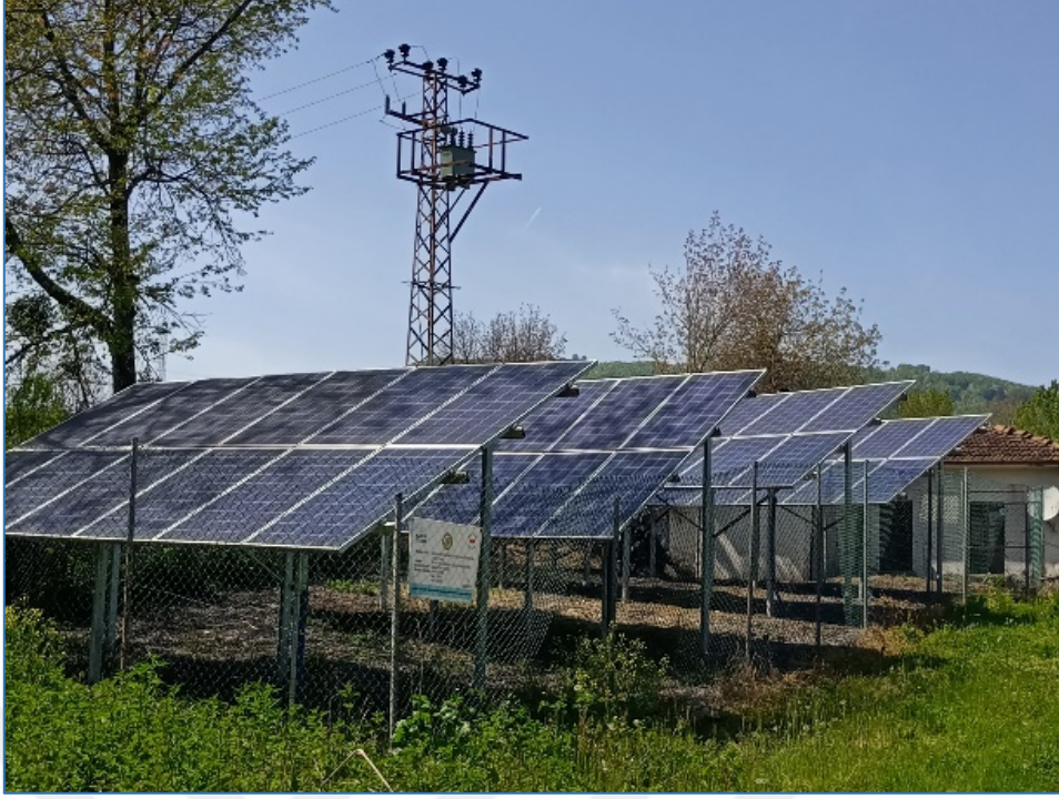
Şekil 8.1. Düzce-Çilimli ilçesi Söğütlü köyünde yapımı tamamlanan PV tesisi.
