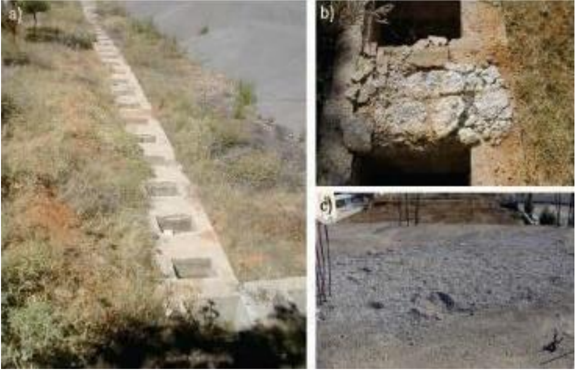
Şekil 1.2. a) ve b) Uşak Eşme’de donma-çözülme hasarına uğramış betonarme temel c) Denizli’de bir betonarme döşemede oluşan taze beton hasarı [5].
