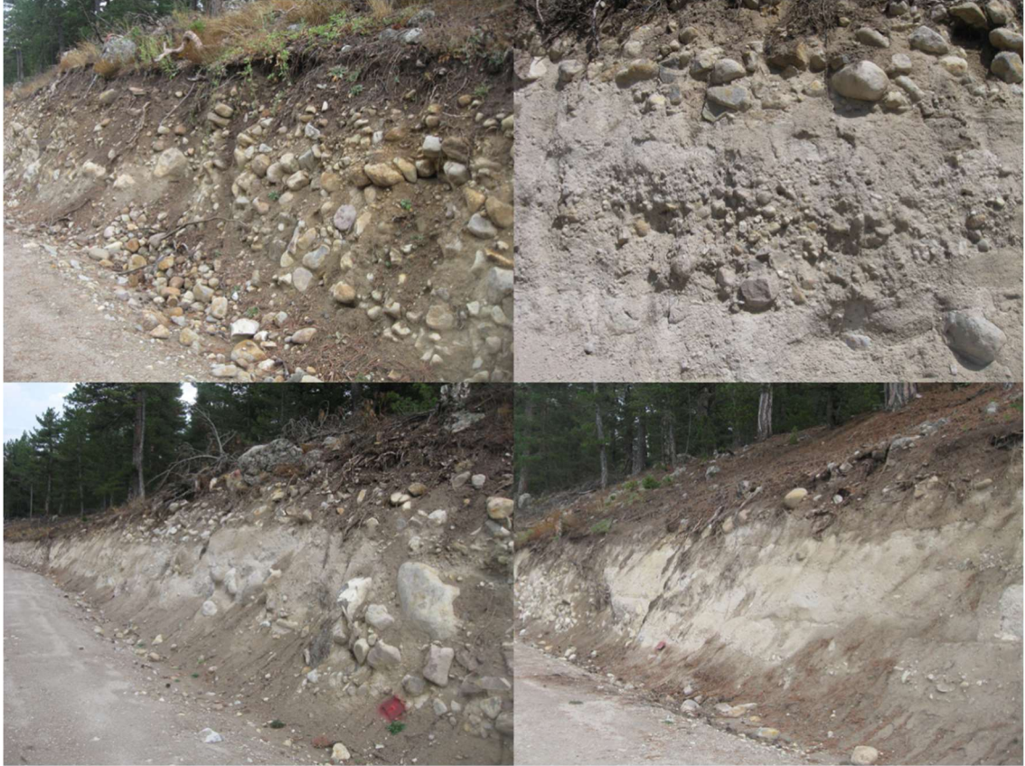
Şekil 3.5. Kazı şevinde meydana gelen deformasyon görüntüleri.
