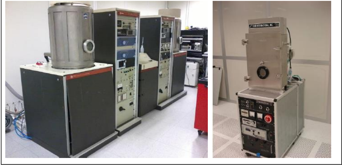
Şekil 3.17. Temiz oda laboratuvarlarında bulunan metal buharlaştırma sistemleri.
