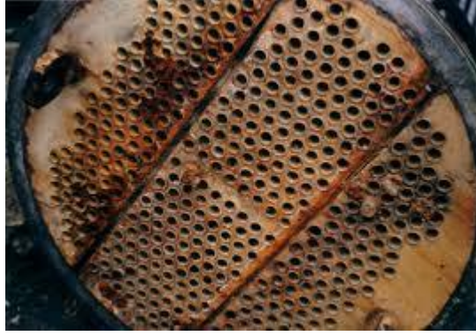
Şekil 1.2. Korozyona uğramış bir ısı değiştirici [16].
