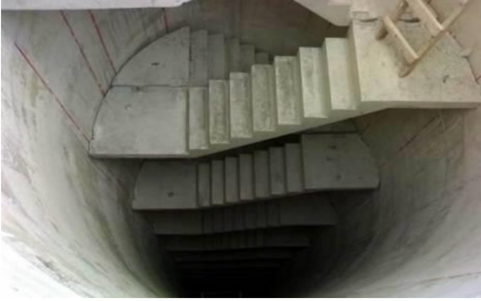
Şekil 3.5. Güvenlik önlemi alınmayan yapı boşlukları.
