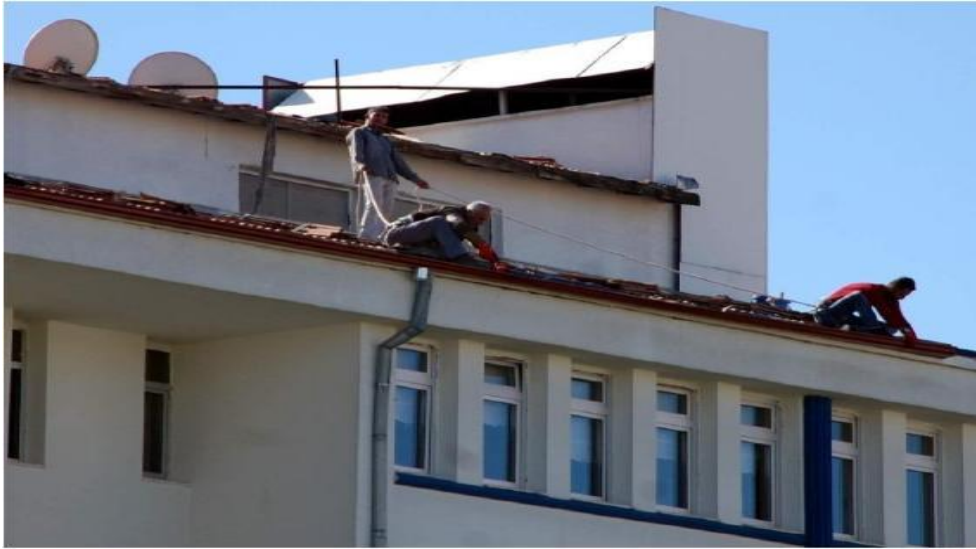
Şekil 3.6. Çatıda güvenlik önlemi alınmadan yapılan çalışma.
