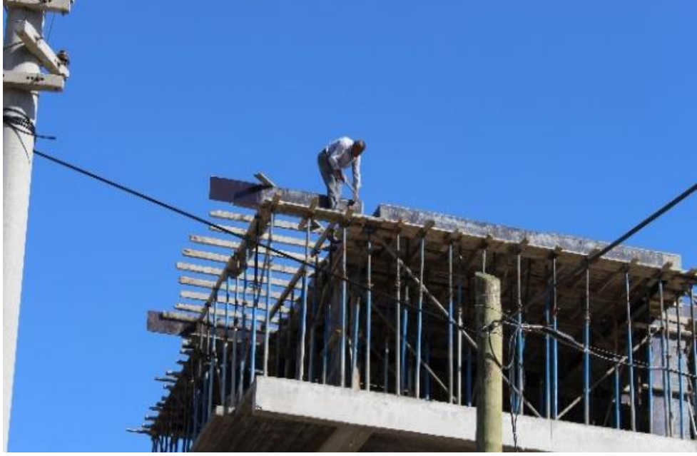
Şekil 3.3. Döşeme ve platform kenarında güvenlik önlemi alınmadan yapılan çalışma.
