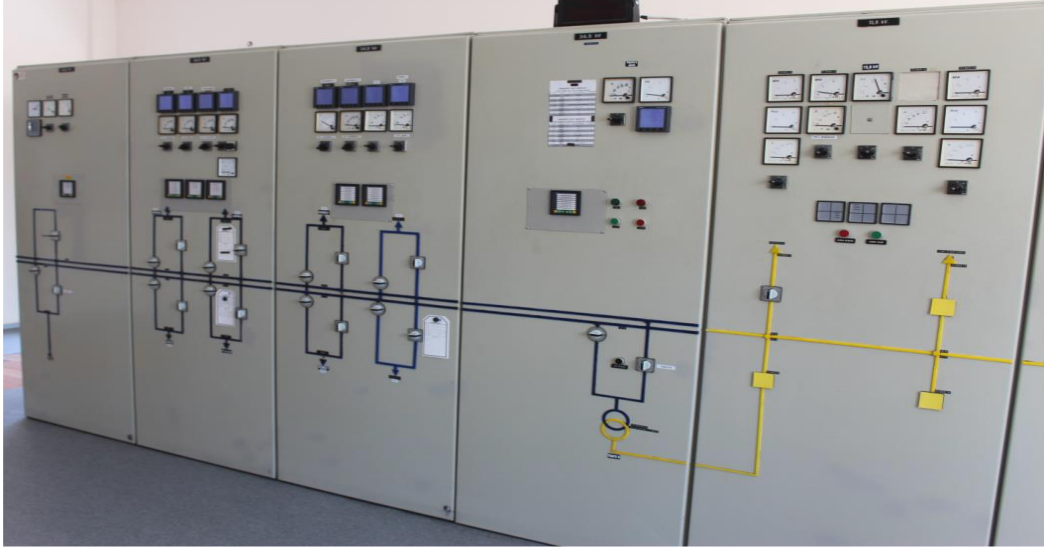
Şekil 2.12. Trafo Merkezi(TM) Kumanda Odası
