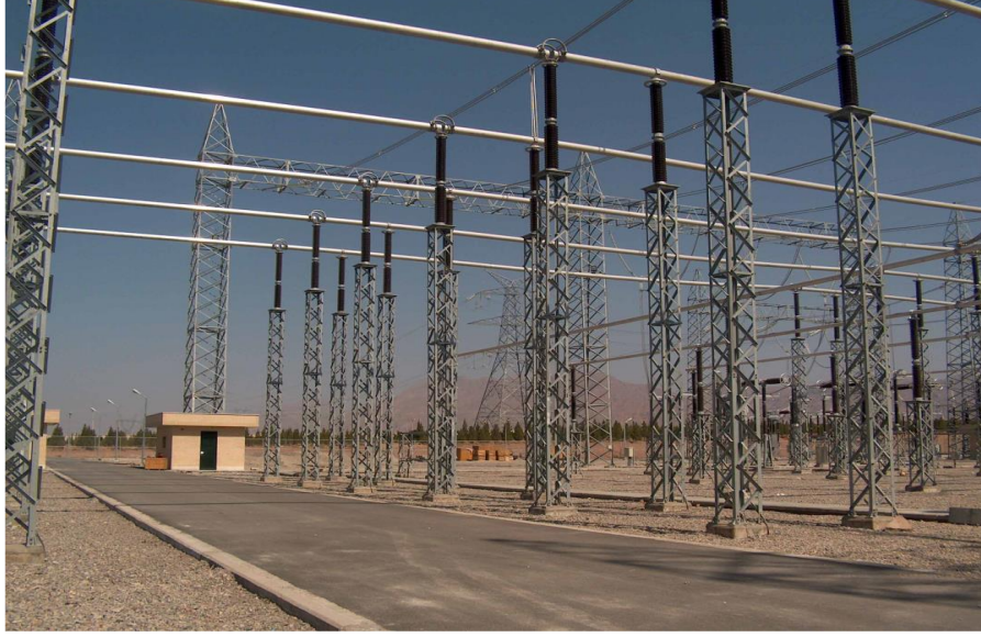
Şekil 2.22. YG Şalt Sahasında Bulunan Baralar
