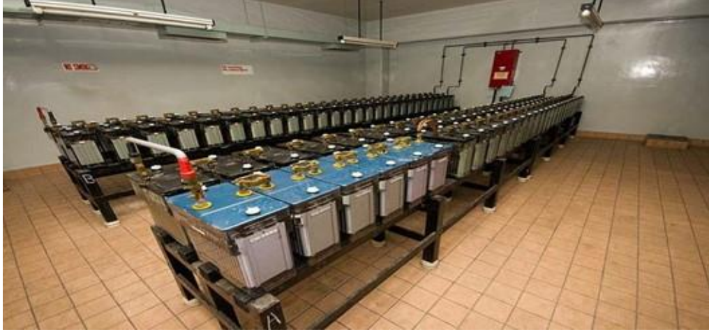
Şekil 2.13. Trafo Merkezi Akü Odası
