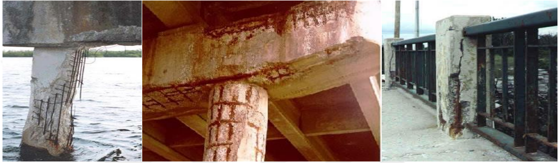
Şekil 1.6. Çeşitli köprü ayakları ve köprü parapet mesnetindeki korozyon kaynaklı hasar [8].
