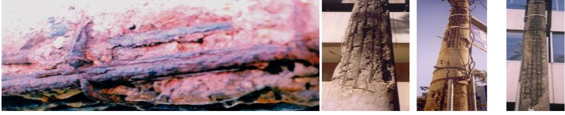
Şekil 1.5. Kiriş elemanda ileri düzeyde korozyon hasarı [7] ve İzmir’de korozyon hasarına uğramış elektrik direkleri [4].
