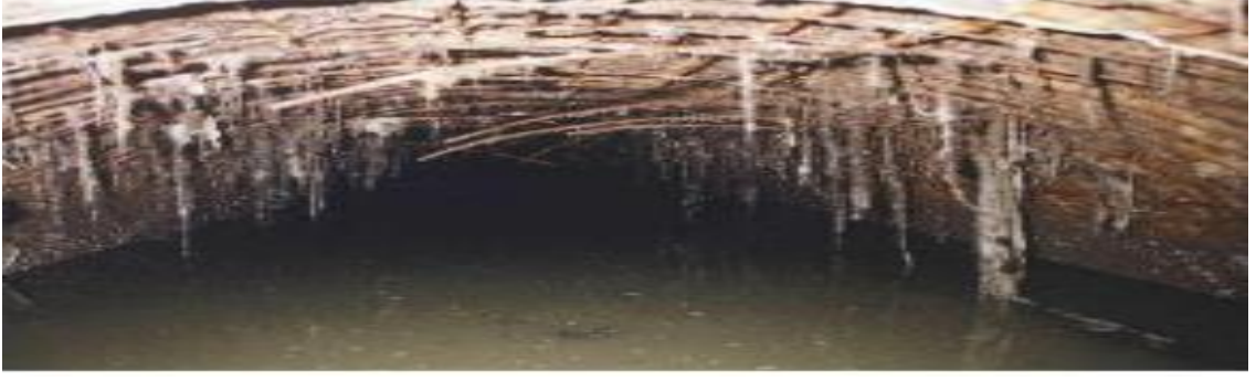
Şekil 1.9. Atık su ve kanalizasyon sistemlerinde sülfürik asit etkisi sonucu korozyon [9].
