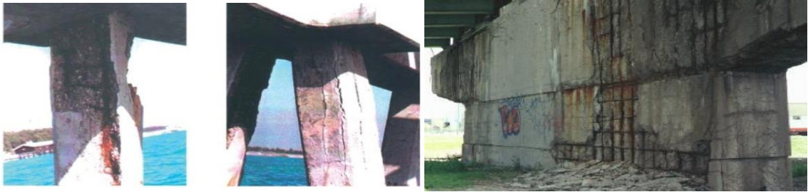
Şekil 1.7. BOTAŞ petrol platformunda meydana gelen yapısal hasarlar ve diğer bazı köprü ayaklarındaki hasarlara örnekler [8].
