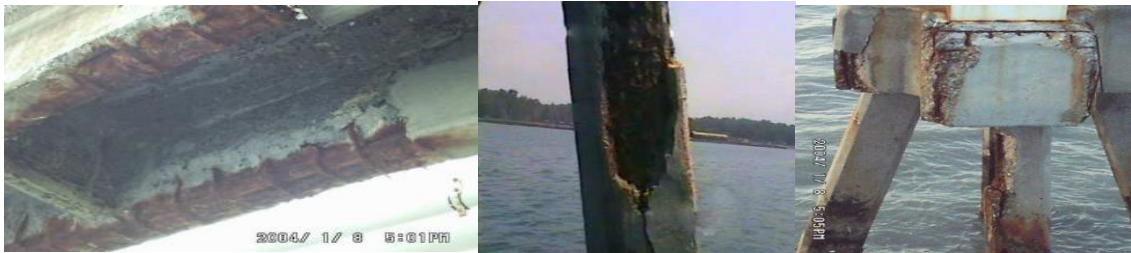
Şekil 1.8. BOTAŞ petrol platformunda korozyon kaynaklı meydana gelen yapısal hasarlar [8].
