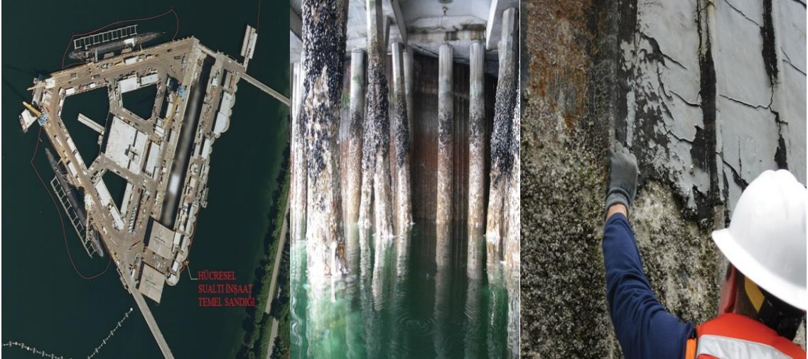
Şekil 1.11. Denize yakın ortamlarda korozyon hasarları [11].
