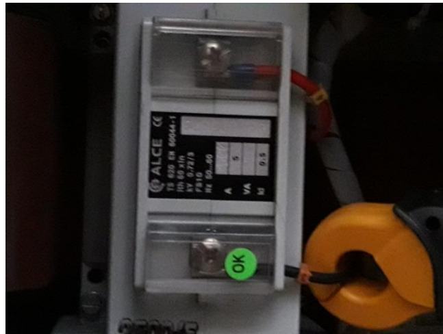
Şekil 10.2. Analizator akım trafosu bağlantısı
