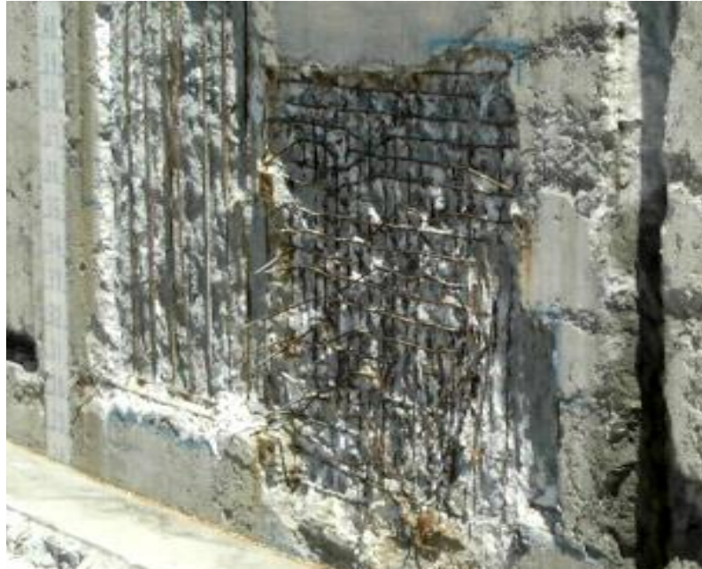
Şekil 2.2 Donatıya ulaşan klorun donatıda meydana getirdiği korozyon sorunları.
