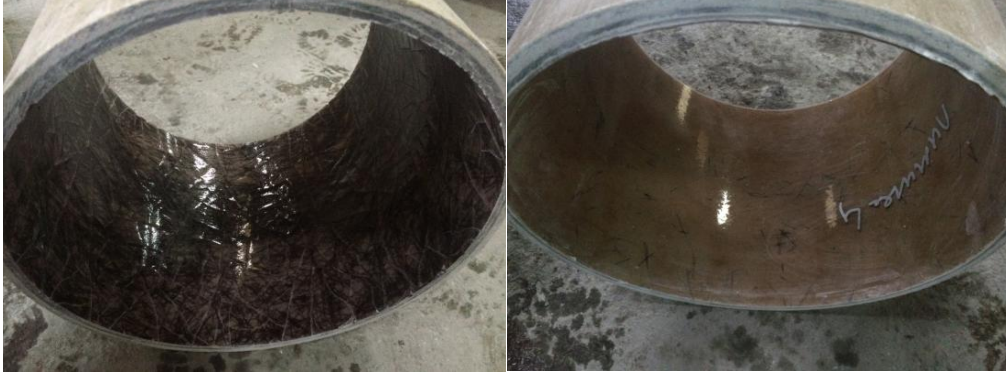
Şekil 3.6. Boru No-2 ve Boru No-4 iç yüzeyi.
