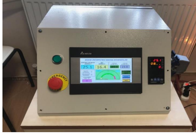
Şekil 3.8. PLC kontrol ünitesi.
