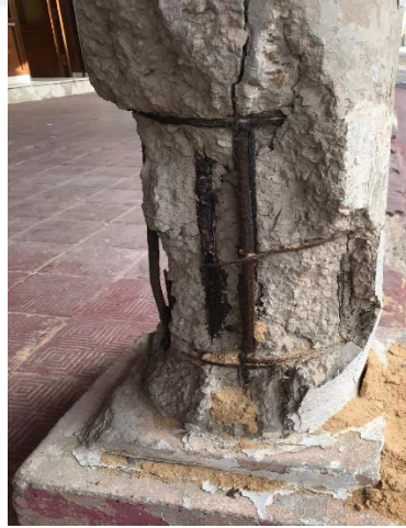
Şekil 1.1. Betonarme yapıda meydana gelen parçalanma.
