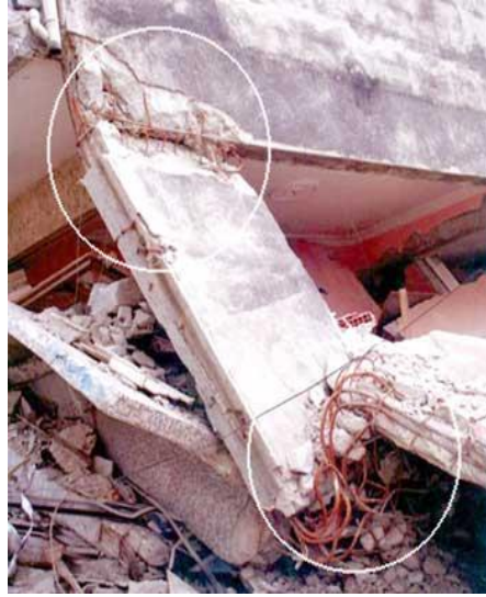
řekil 1.5. Korozyon nedeniyle meydana gelen hasarlar.
