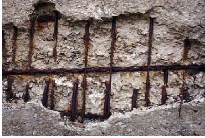
Şekil 1.4. Korozyona uğramış giriş donatıları.
