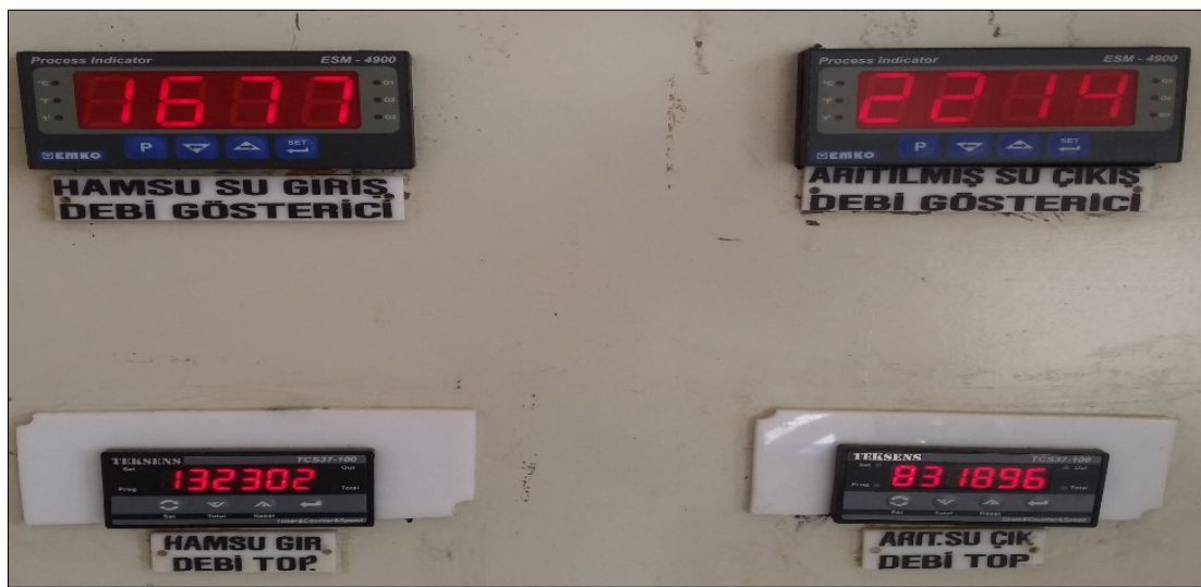
Şekil 2.12. Arıtma tesisi anlık debi panosu verileri.
