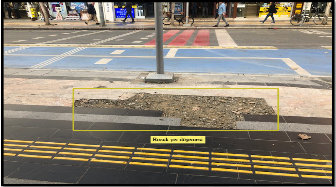
Şekil 3.6. Yaya yollarında bozuk yer döşemesi (Orijinal, 2019).
