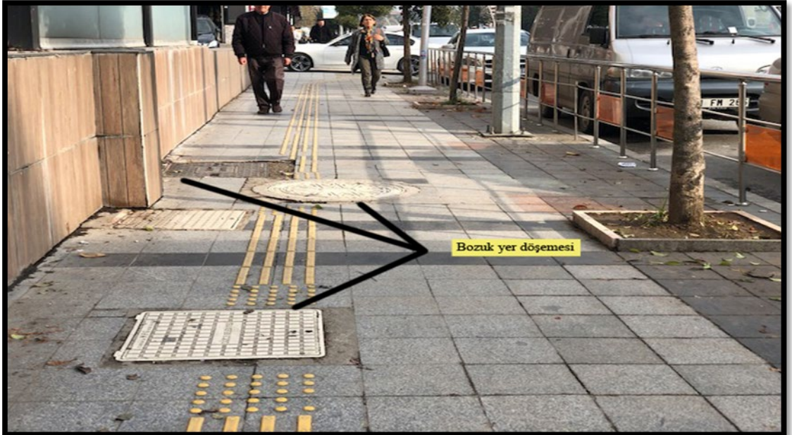
Şekil 3.7. Yaya yollarında bozuk yer döşemesi (Orijinal, 2019).
