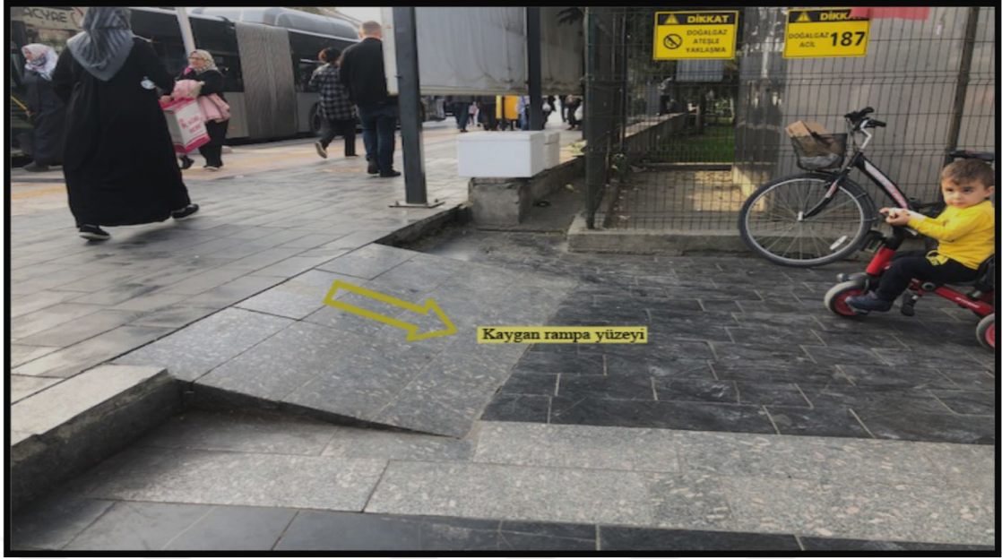
Şekil 3.12. Rampaya uygun olmayan yer döşemesi (Orijinal, 2019).
