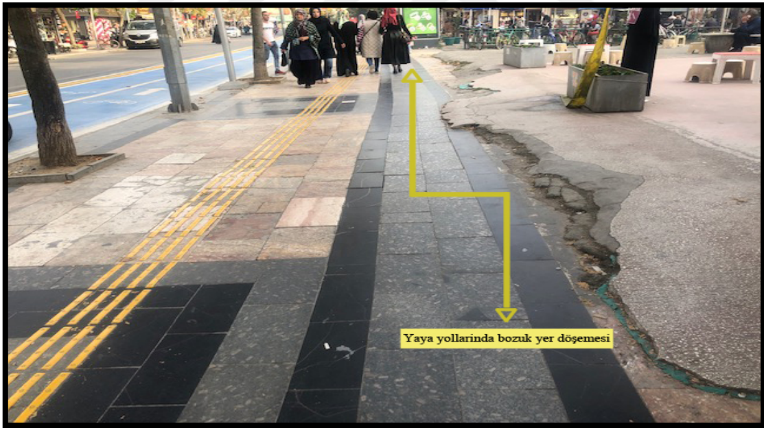
Şekil 3.3. Yaya yollarında bozuk yer döşemesi (Orijinal, 2019).
