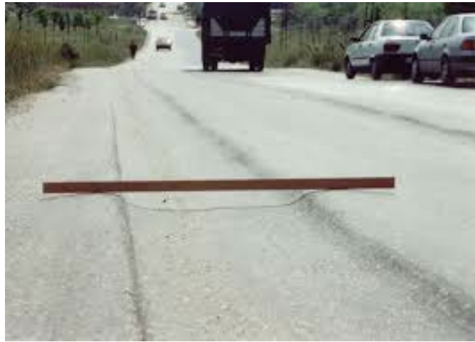
Şekil 1-4. Tekerlek izi oluşumu (İskender, 2004).
