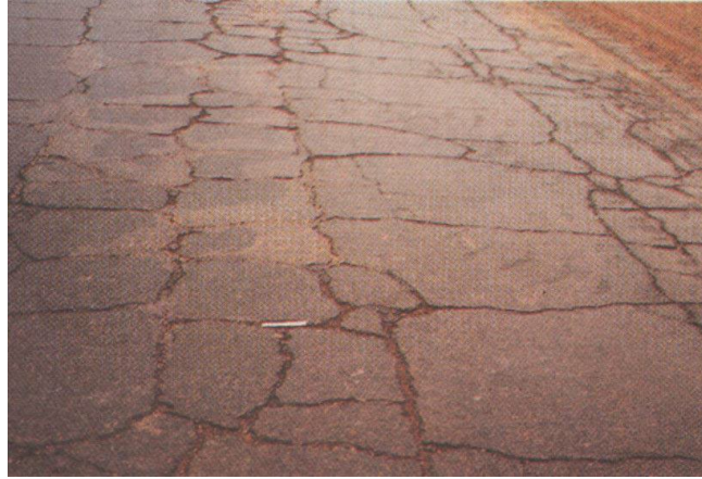
Şekil 1-5. Üstyapıda oluşan çatlama (Hanlı, 2009).
