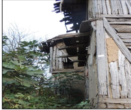
Şekil 4.65. Kuzey cephesi hasar gören balkon.
