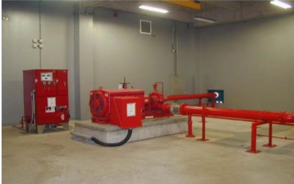
Şekil 4.6. Uygun renkte boyanan ve çelik levhayla yangın kontrol paneli ve pompası.
