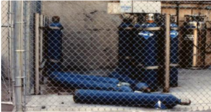
Şekil 3.6. Deprem sırasında gaz tanklarının devrilmesi (FEMA, 2012).
