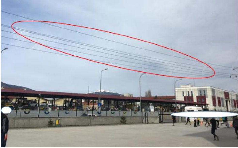
Şekil 6.35. Okul bahçesinin üzerinden geçen yüksek gerilim hattı.
