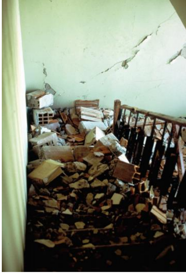
Şekil 3.2. Yıkılan duvar nedeniyle çıkış yollunun kapanması (FEMA, 2012).
