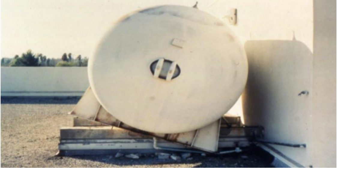
Şekil 3.5. Northridge depreminde tanktaki ankarajın eksik olması sebebiyle işlevini yerine getirememesi (FEMA, 2012).
