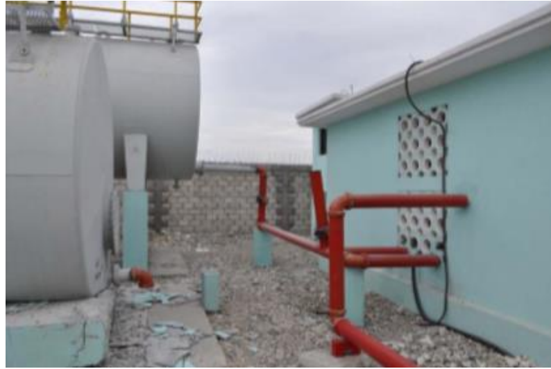
Şekil 3.9. Boru tesisatının kullanım dışı kalması.
