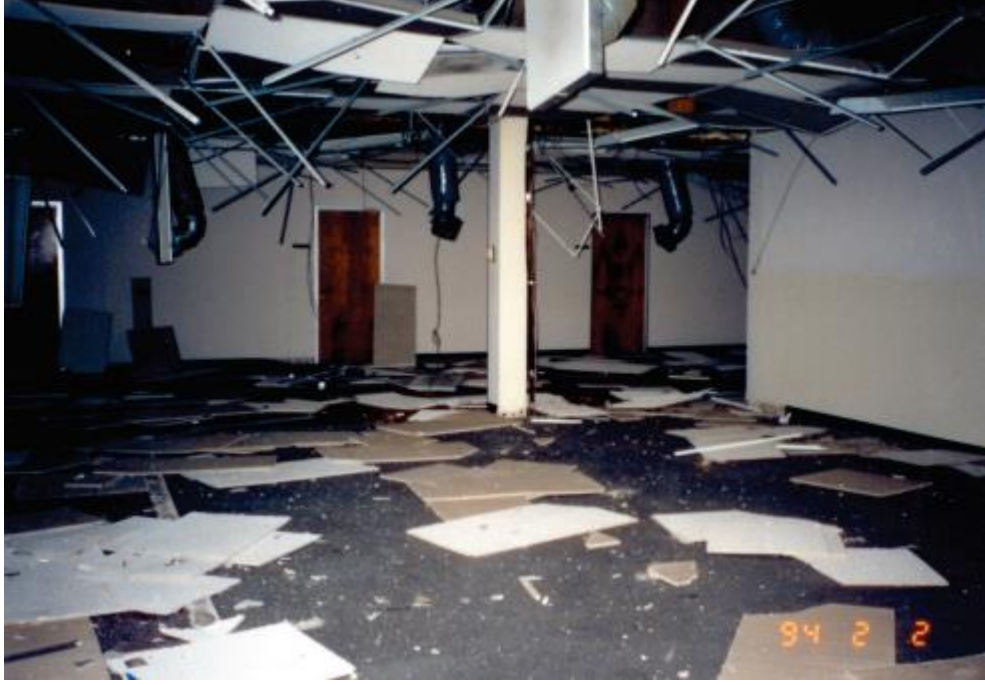
Şekil 3.1. Deprem sırasında hasar görmüş asma tavan (FEMA, 2012).
