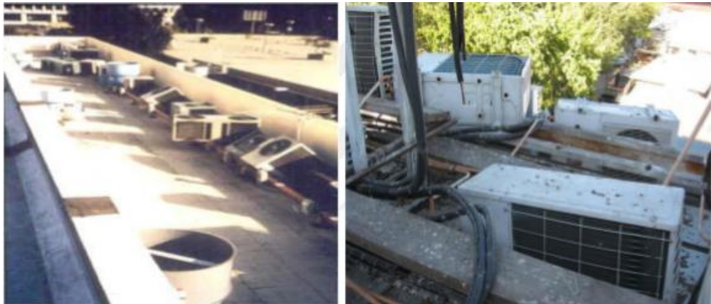
Şekil 3.4. Deprem nedeniyle çatı ünitelerinin düşmesi (FEMA, 2012).
